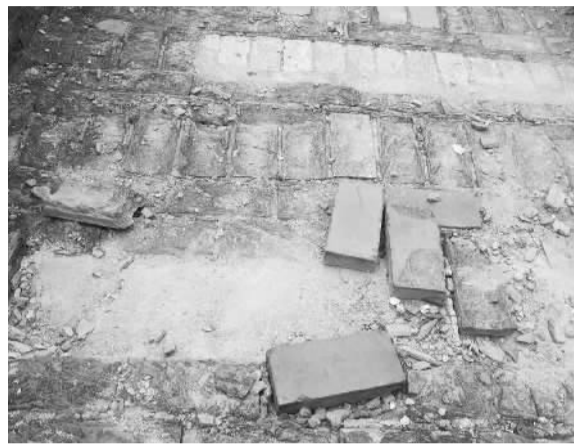
景区部分城墙上的砖块完全没有固定。
