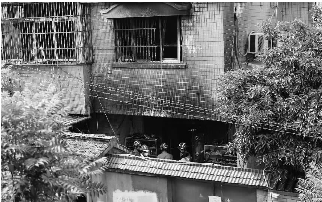
7月16日，工作人员在火灾事故现场忙碌。 新华社发
