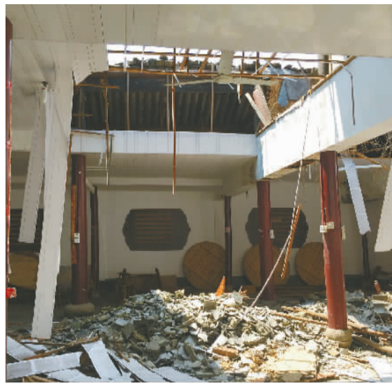
永思堂的坍塌处
