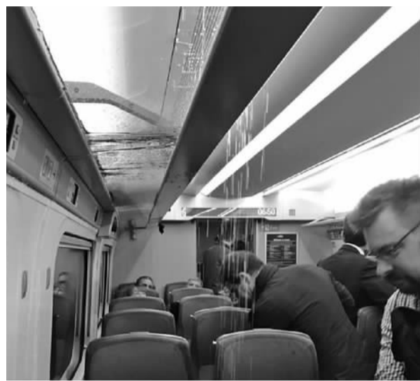
车厢里漏成了“水帘洞”。
