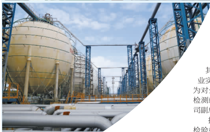
高大密闭的球形储罐。
