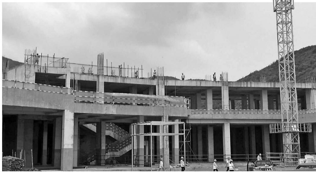
正在建设中的象山喜来登度假酒店项目。象山县住建局供图
