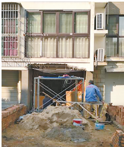
违建施工现场。
