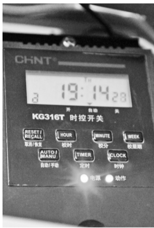
镇海蛟川街道中一社区大院内的时控开关，在此开关控制下，晚上6点到8点开户外灯，方便居民跳广场舞。
