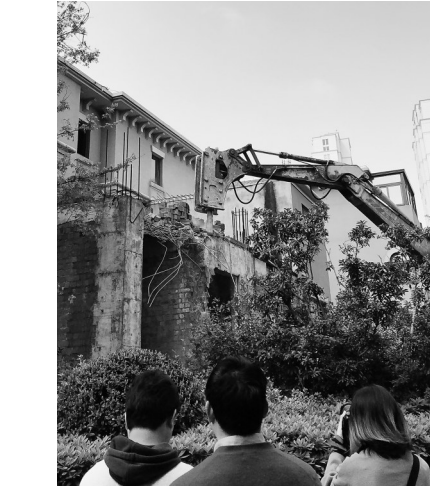
昨天，御玺园小区内一违法搭建被拆除。
