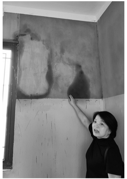
蒋女士指着渗漏潮湿的墙面。
