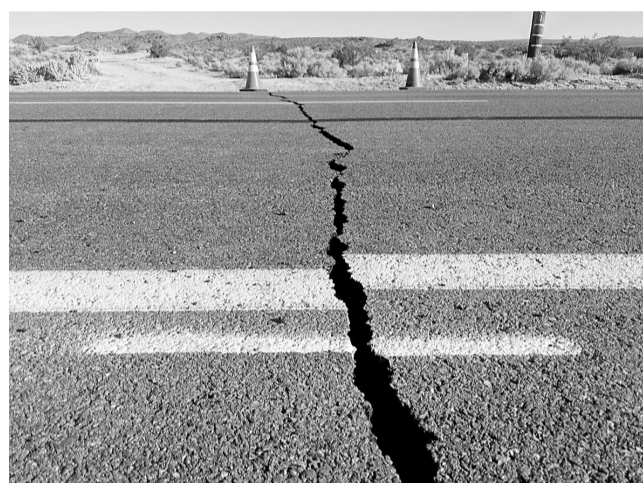
7月6日,在美国加利福尼亚州小镇特罗纳,道路在地震中受损(手机照片)。新华社发
