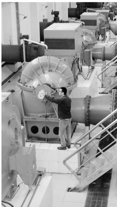
工业供水出水泵房,职工定期维保大型出水泵。
