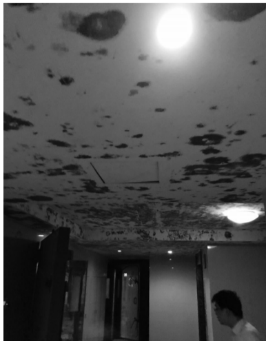
小区地下室发霉严重
