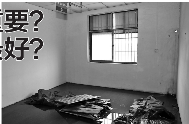
安装普通直立式喷头的房间，火已被浇灭。
