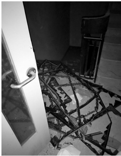
17楼消防通道，满地的碎玻璃。
