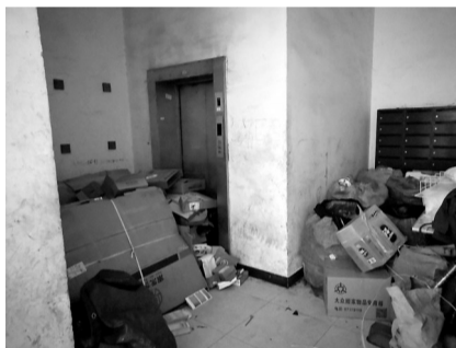
1号门厅，堆满垃圾。
