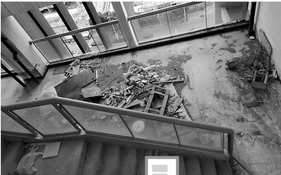
17楼连廊，垃圾成堆。
