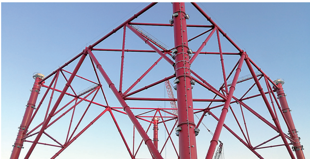
石墨烯改性重防腐涂料应用于国网380米世界最高跨海输电铁塔。
