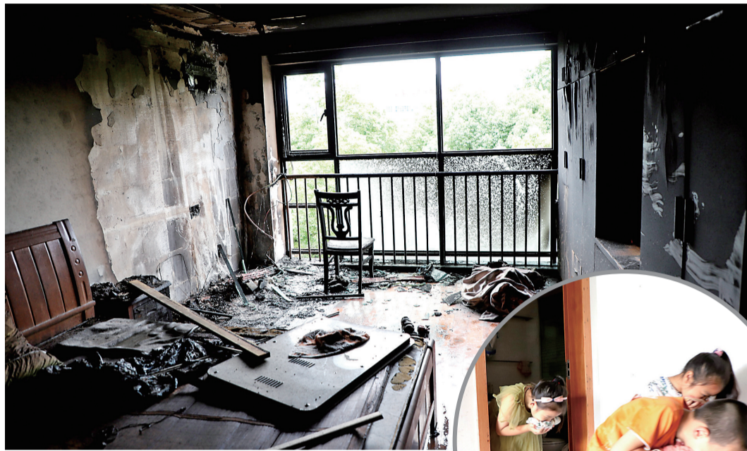
发生火灾后的卧室。通讯员供图
