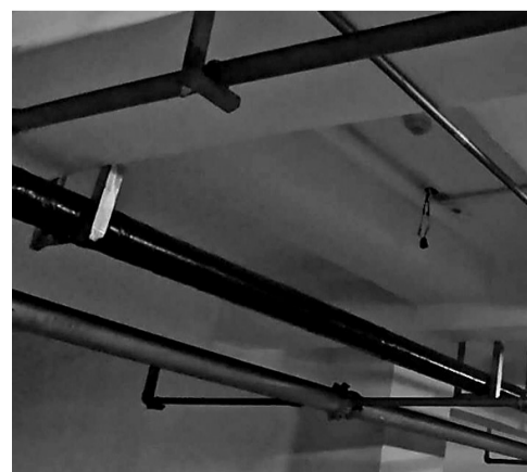
装有通风设备的小区地下车库,冷凝水现象并不严重。
