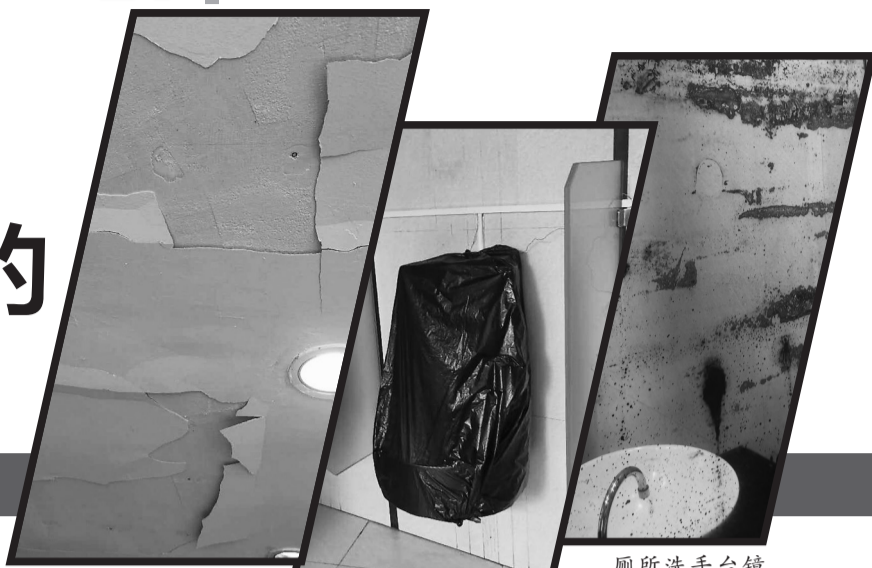
卫生间天花板涂料掉皮脱落。
