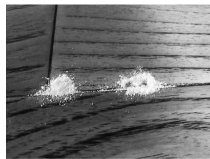
实木地板被白蚁蛀空,出现大量白色粉末。 通讯员 供图
