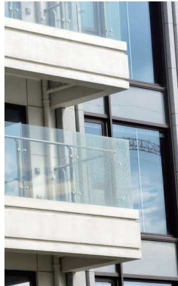
阳台上出现裂缝的玻璃
