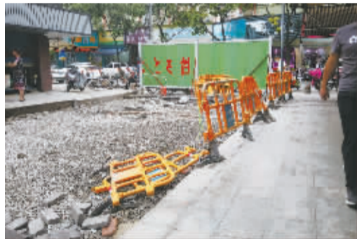
华严菜市场旁边道路维修存在安全隐患。
