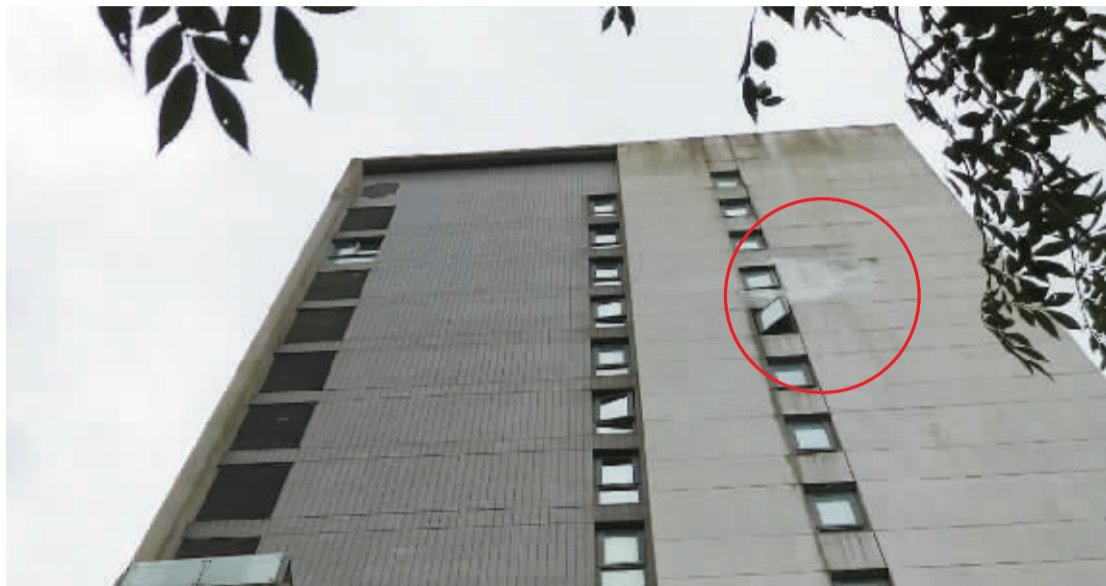
画圈处为金地国际花园外墙脱落处。
