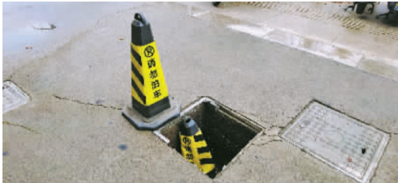
人行道上窰井盖缺失(下应街道)。
