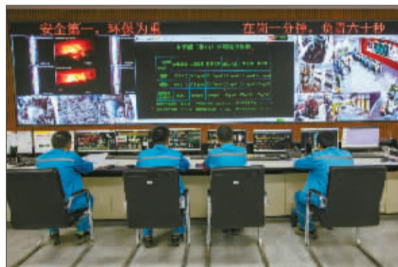
工作人员在中央控制室用先进可靠的仪控设备DCS集控系统全程监视控制:垃圾接收贮存系统、垃圾焚烧线、热力系统、汽轮发电机组、燃油泵房、厂用电系统及辅助生产系统等,同时还可以监控焚烧后排放物是否达标。
