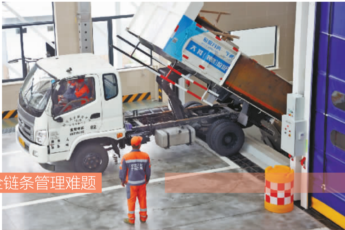
嵩江固废转运站大件垃圾处置系统试运行。 通讯员供图
