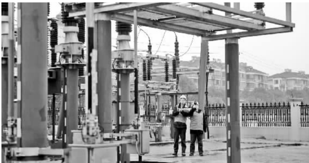
为保障低温雨雪冰冻来袭时，余姚居民生产生活安全用电，国网余姚市供电公司全面做好防雨雪冰冻各项工作。昨日，在商量岗上，国网余姚市供电公司梁弄供电所陈立峰、倪建荣冒着小雨对该段线路进行寒潮前特巡。
