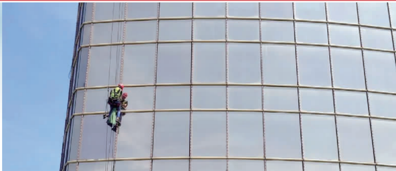
▲7月12日,宁波第一百货,照明吊装检修工人正在高空作业。应健 摄
