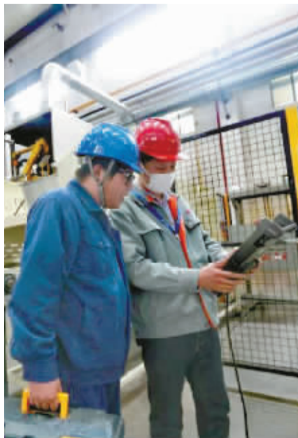
国网宁波供电公司员工在灵峰工业园检查电力设备。 通讯员 曾江 摄
