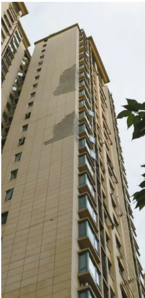
齐和家园小区部分楼幢外墙脱落严重。
