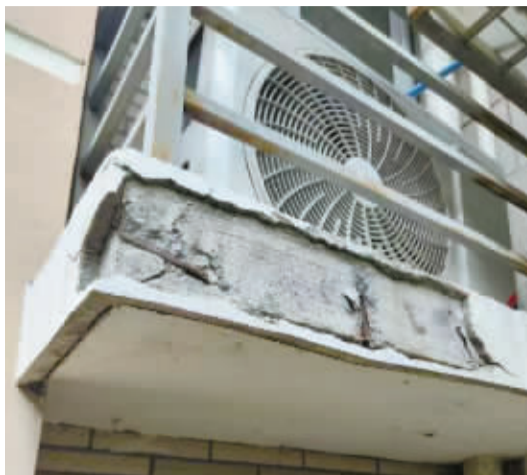
小区外墙脱落场景。
