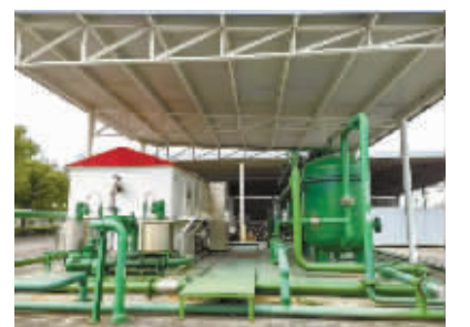
油库的污水处理系统。
