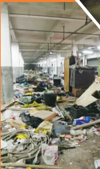
▲原来破败不堪的地下储物间。
