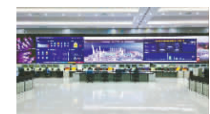
中国石化镇海基地1#地块中央控制室。
