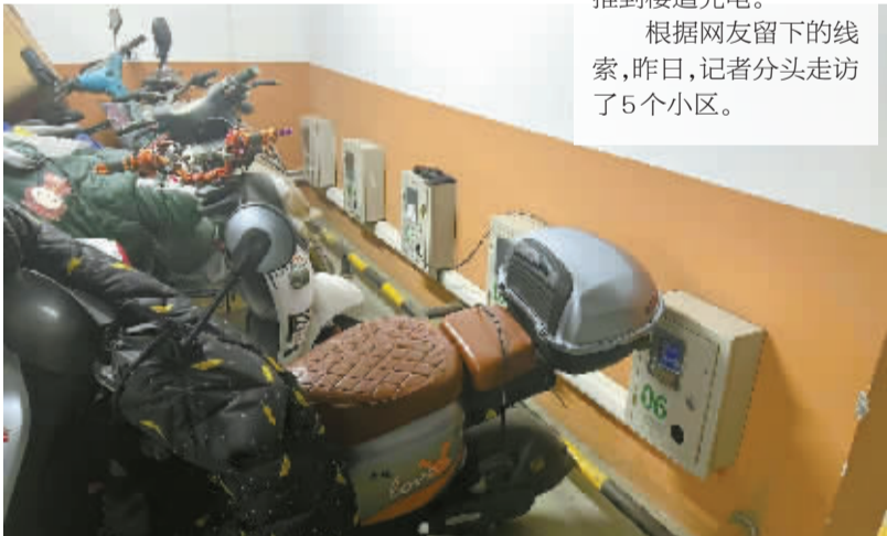
▲荣安和院小区,电动自行车在地下一层充电。
