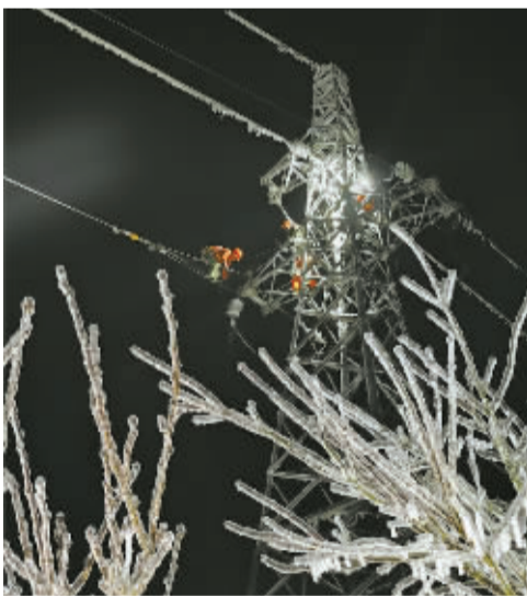
▲ 2月27日凌晨4时许,电力工作人员仍在高空抢修。天亮前,他们完成海曙辖区全面复电。 朱珊珊/摄
