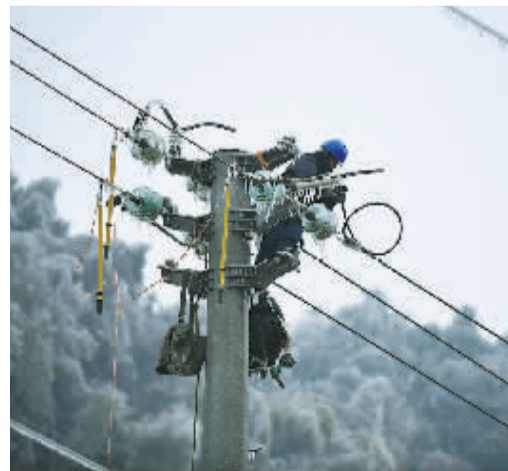
▲ 2月25日,国网余姚市供电公司工作人员对四明山镇黎洲村10千伏隐患线路进行修复。 吕洪波/摄
