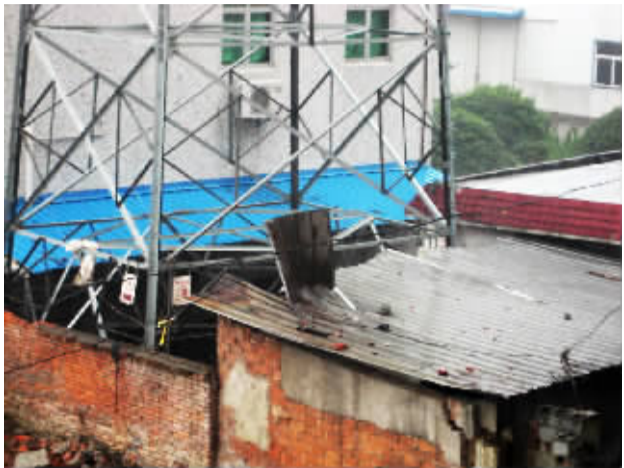
工棚屋顶石棉瓦被掀起。
