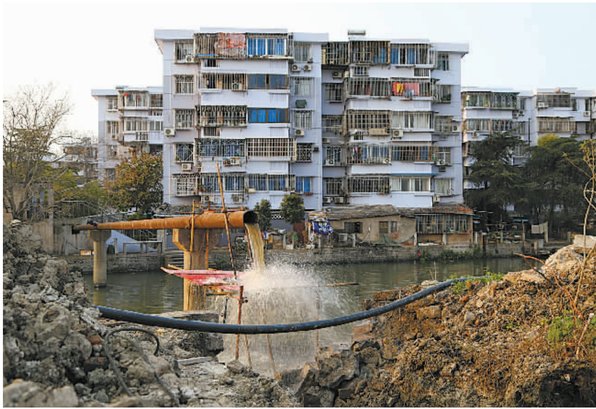
右图为南塘河上被截断的污水管。(曹爱方 朱彬彬 摄)
