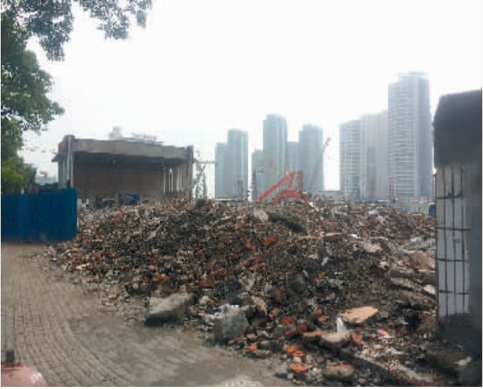
汽车北站拆迁工地围栏缺失区域。
