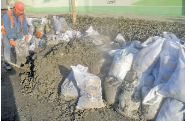
嵩江路雨水管中抠出的大量水泥块，工人正在装袋准备清运。
