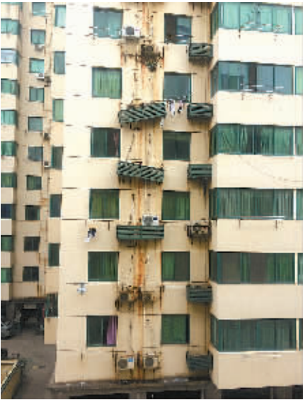
摇摇欲坠的空调外机支架。 (王伊婧 摄)
