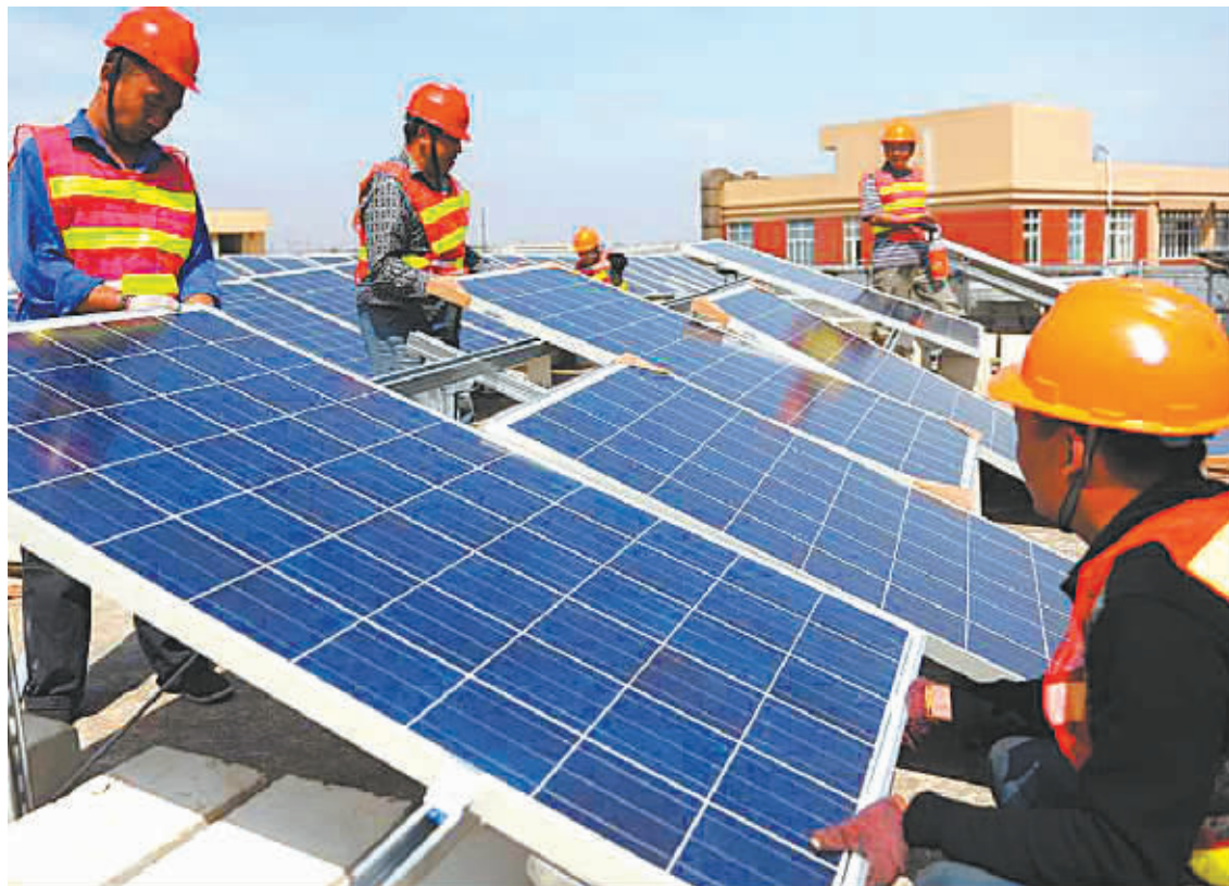
中洲光伏电站并网验收现场。
