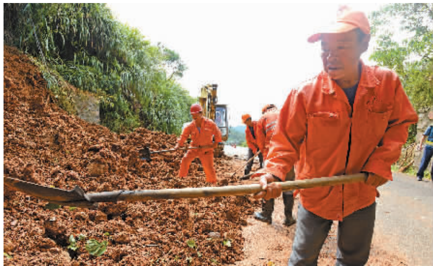
昨天上午,象山路政人员正在抢修水湖涂隧道出口山体塌方。到11时许,道路恢复通行。(徐能 俞莉 陈光曙 摄)
