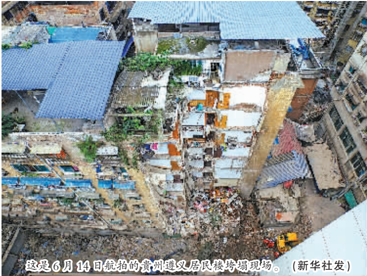
这是6月14日航拍的贵州遵义居民楼垮塌现场。（新华社发）
