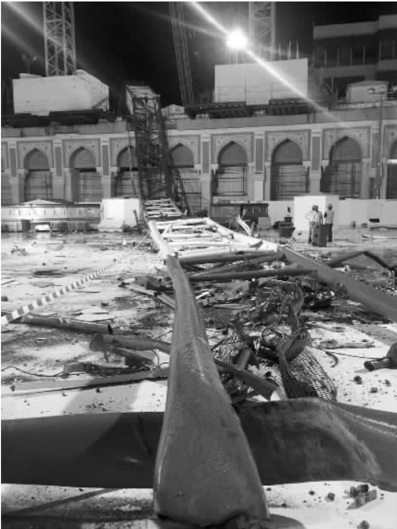
9月11日,救援人员在塔吊倒塌事故现场工作。 新华社发
