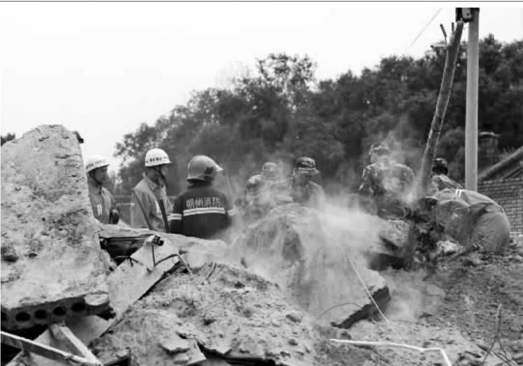
7月10日，朔州市武警官兵与消防人员在坍塌事故现场救援。新华社发
