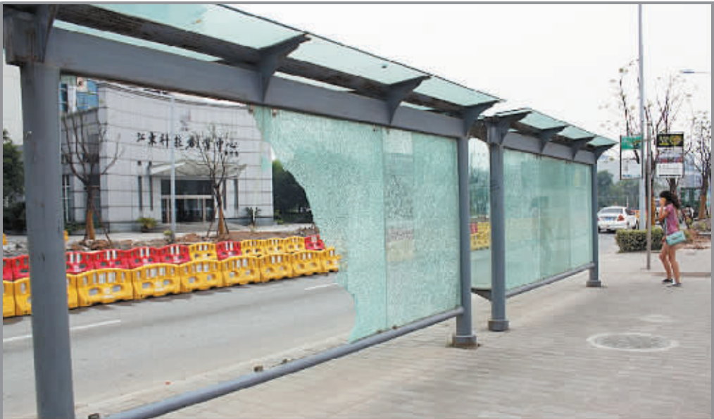
江东科技创业中心对面的钢化玻璃公交候车亭已面目全非。记者 沈之莹 实习生 雷雨田/摄
