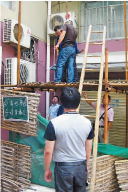
现场悬着一块小黑板，上面写着：“有电危险，请勿靠近。” 记者 沈之蓓 王思勤 摄影
