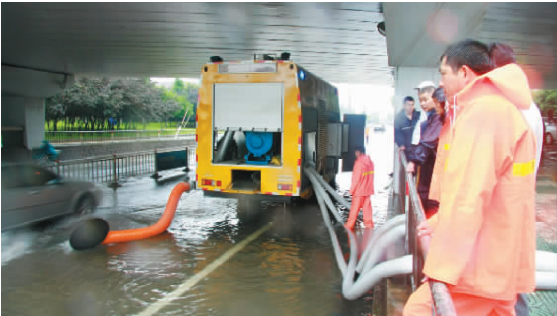
强排在江东北路甬江大桥下排水。（资料图片）
