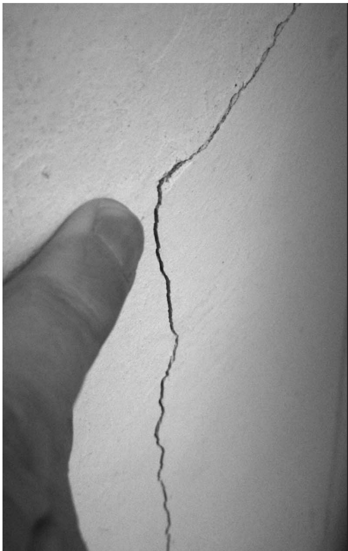
楼道回的外墙开裂严重
