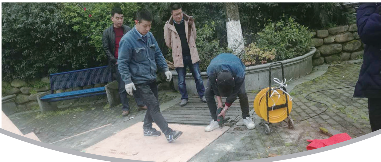
工人们昨日对天水家园一期步道进行维修 记者 陈善君 摄
